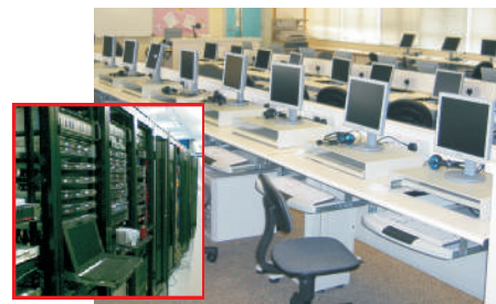
W serwerowniach i sieciach komputerowych przełączniki faz odciążają UPSy
